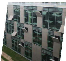
Désenfumage naturel & architectural
